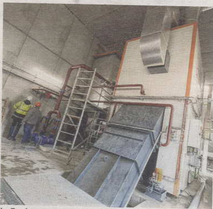
La Dordogne compte déjà 74 chaufferies ou réseaux de chaleur bois tant publics que privés, dont la chaufferie des Deux Rives à Périgueux. ARCHIVES ARNAUD LOTH
